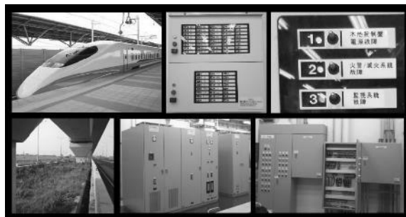
台湾新幹線 17万Vの電車車両基地 変電所施設の監視（OEM）
