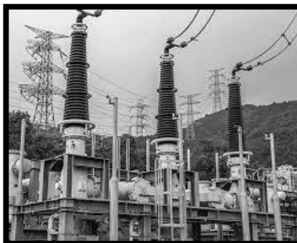
東京電力50万V 電力設備の監視
