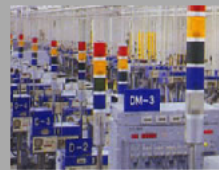
積層灯で稼働管理
