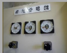
劣化、漏電の監視
