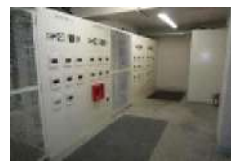
高架タンク(満減水)
